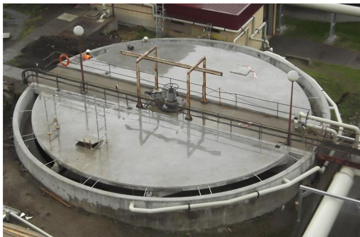
Ilustración 2: Cubierta de espesador de fango en la EDAR de Galindo [8]
