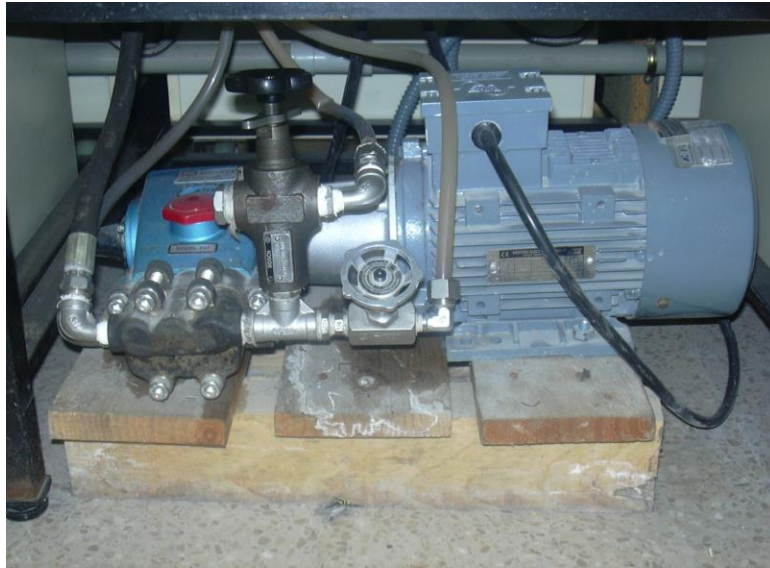
Figura 3.3. Bomba de impulsión
