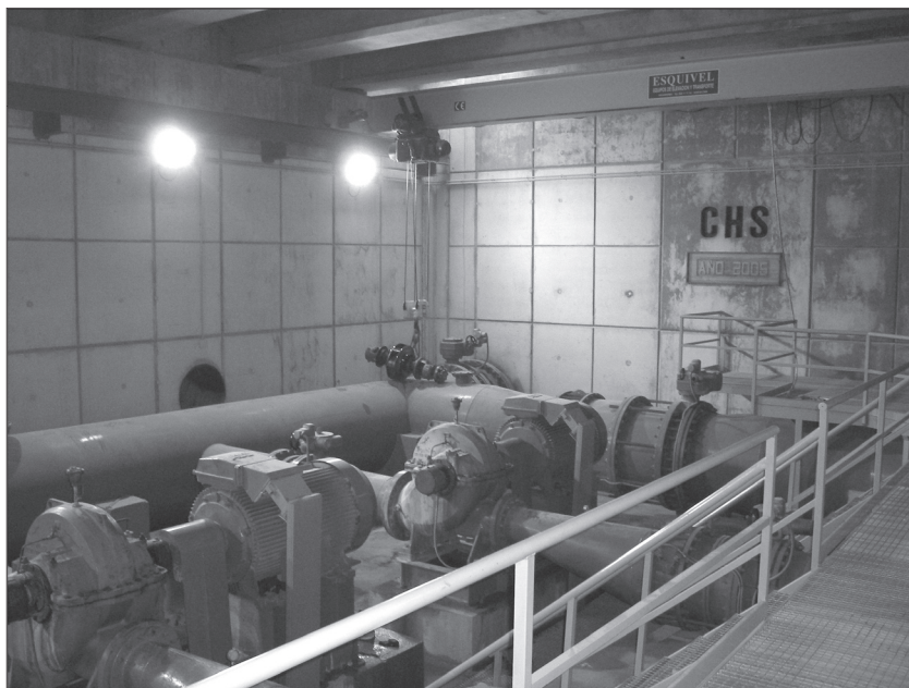
FOTO 3. IMPULSIONES DE AGUA EN LA CASA MATA, C.R. DE LORCA.
